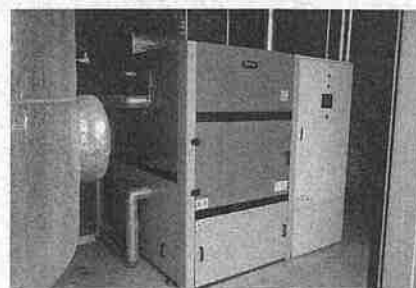
▲ 木質バイオマスボイラー
