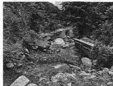
▲林道施設被災状況
