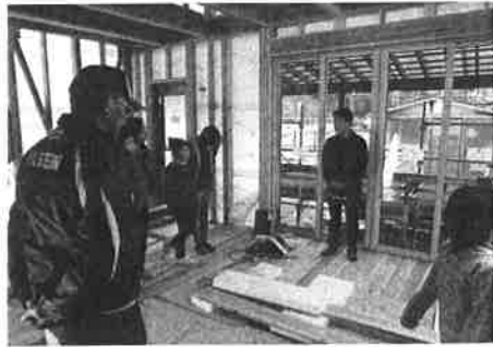
▲写真-4 新築中の地元の木を使用した県産材住宅構造を見学
